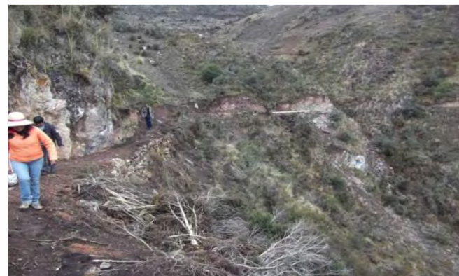
CONSTRUCCION DE SISTEMA DE RIEGO EN LAS COMUNIDADES ALTO ANDINA DE PACHAMARCA
