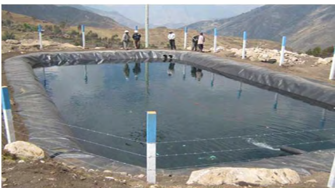
MEJORAMIENTO DEL SISTEMA DE RIEGO DE LA ZONA ALTO ANDINA DEL DISTRITO DE PAUCARBAMBA
